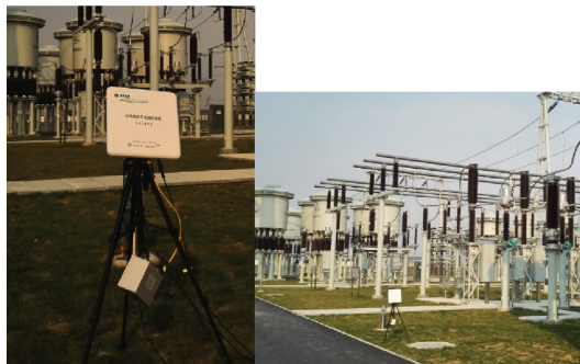
图 7 电压实验现场图
